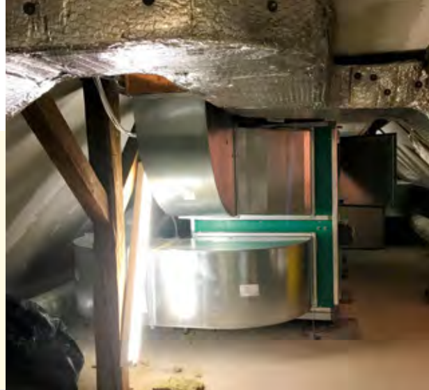
Lüftungs-Monoblock im Estrich
